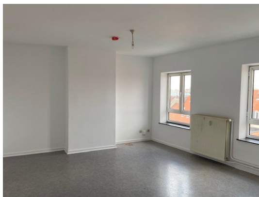
Appartement NA het in goede staat herstellen
